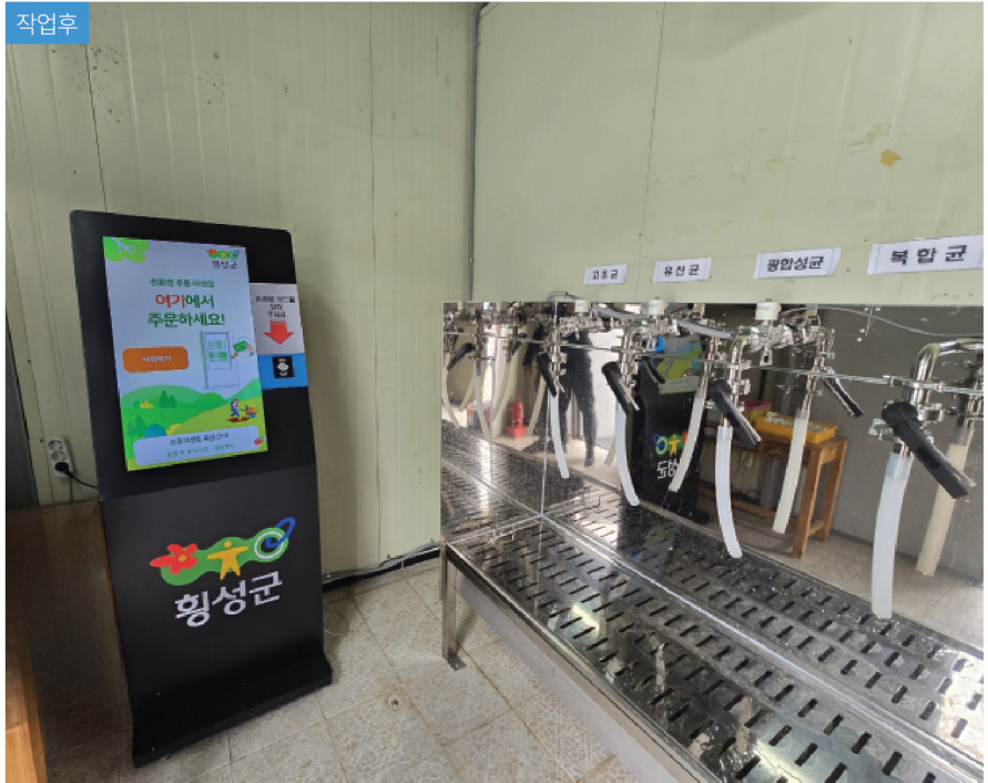
자동분주대와 키오스크 설치
