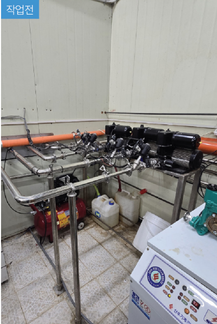
기존 이송배관라인 및 펌프
